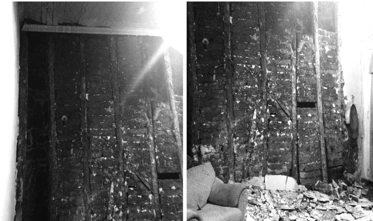
FIGURA 6. PROBLEMAS INHERENTES A LA VIVIENDA ANTIGUA EN EL BARRIO PUERTO: CONSTRUCCIÓN EN ADOBILLO
